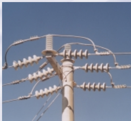
Stützisolatoren und Kappenisolatoren an einer Freileitung
